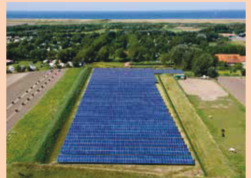
PV-panelen in het Zuid-Hollandse Ouddorp aan het zicht onttrokken door meer dan honderd jaar oude zandwallen (De Klepperstee)
