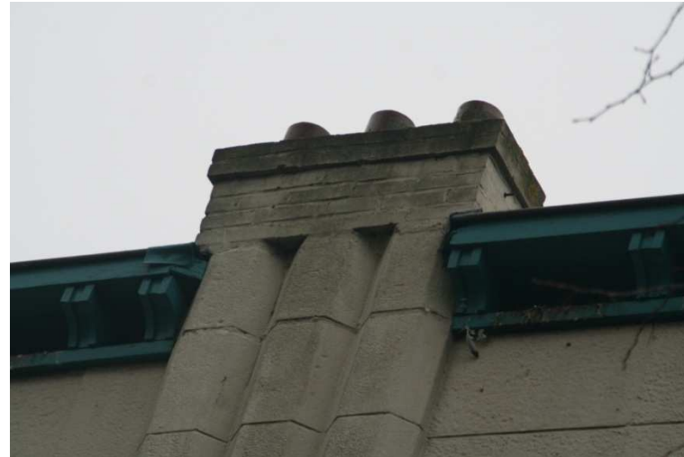
De schoorstenen in de kopgevels zijn bij een eerdere renovatie opgemetseld. We willen nu de oorspronkelijke betonnen elementen terugbrengen.
