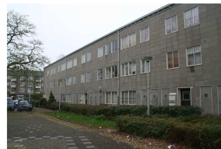
Vier blokken zijn in het verleden niet geschilderd. Hier heeft de gevelbeplating nog zijn oorspronkelijke kleur en structuur, waarbij de tand des tijds uiteraard wel afleesbaar is.
