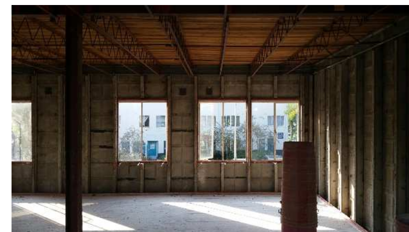
De woningen zijn van binnen uit geheel kaal gestript. Daarna zijn er nieuwe inbouwpakketten gemaakt die energetisch aan de hoogste eisen voldoen.
