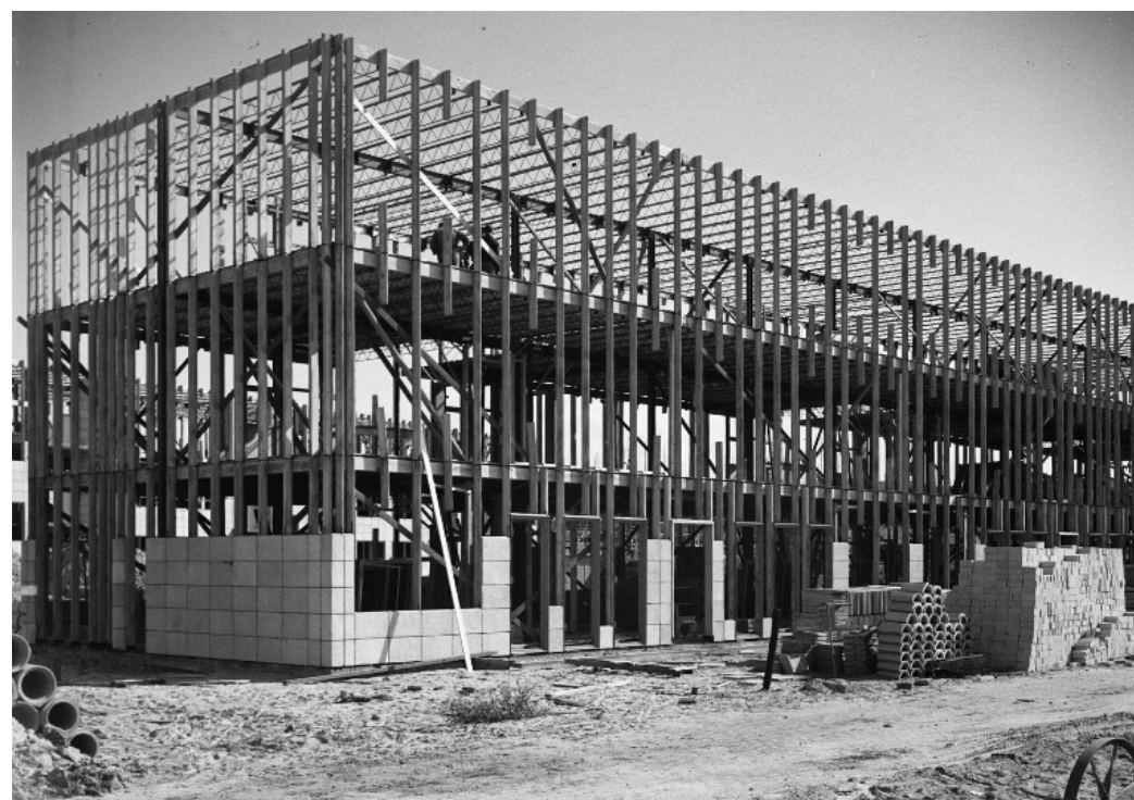
Deze in het begin van de vijftiger jaren gerealiseerde systeembouw woningen in het Nevamo Airey systeem zijn opgebouwd uit een lichte staalconstructie met prefab betonnen gevelplaten.
