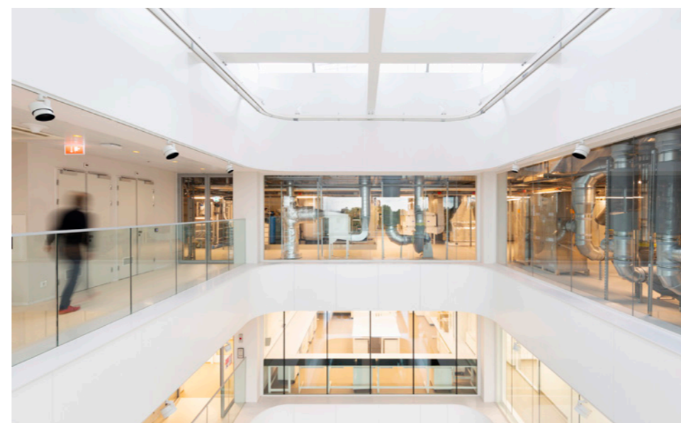
Zicht op technische ruimten
